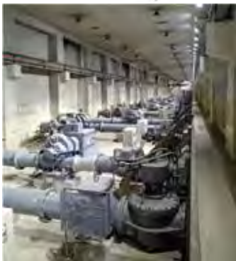
●送水ポンプ(柏井浄水場)
