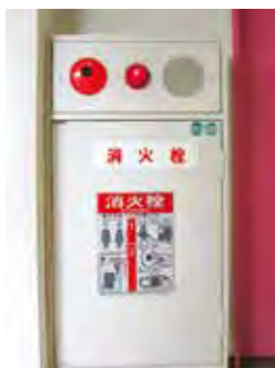
消火栓と火災報知器
