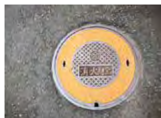
道路の消火栓
