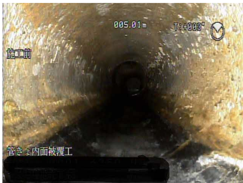
老朽化した下水道管の内部
