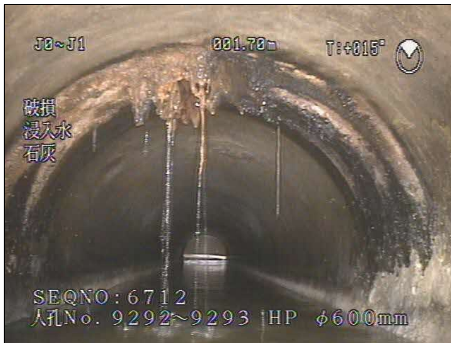
下水道管の内部（破損、浸入水）
