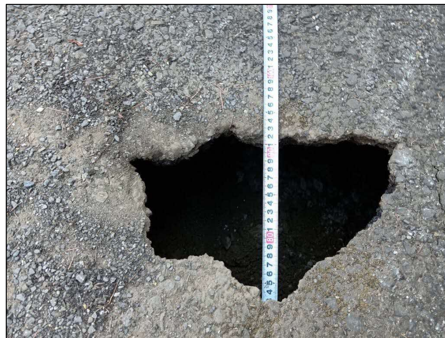
道路陥没（千代田地区）
