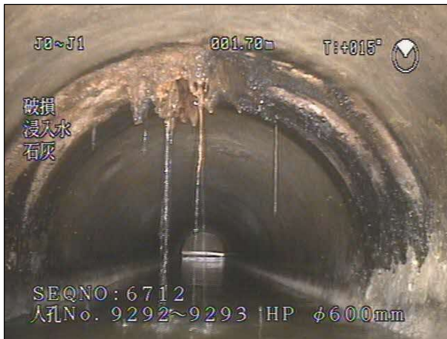
下水道管の内部（破損、浸入水）
