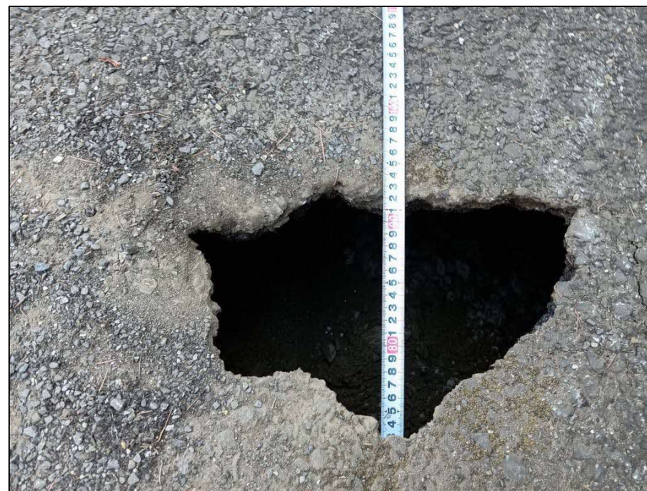
道路陥没（千代田地区）
