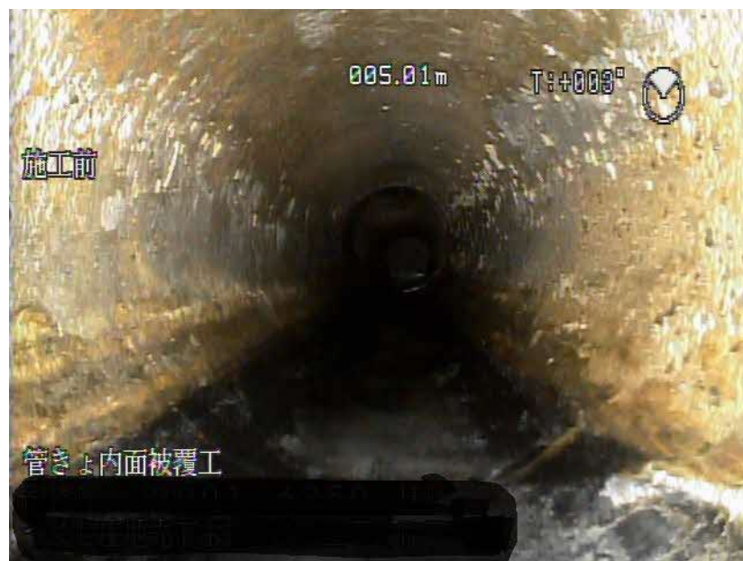
老朽化した下水道管の内部
