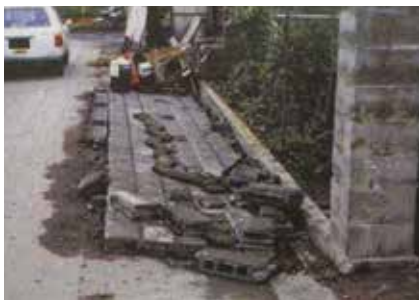
▲倒壊したコンクリートブロック塀
