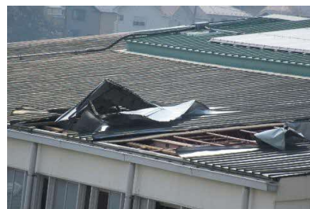
■ 令和元年台風15号による被害状況
